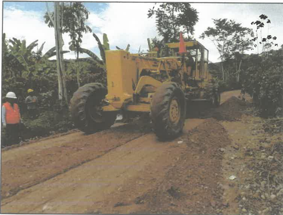
FOTOGRAFIA N° 04: Se puede apreciar en la imagen el uso correcto de los implementos de seguridad en obra.
