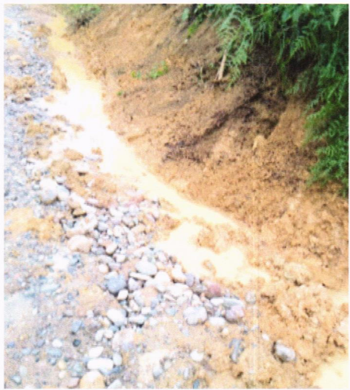
FOTO N° 05 En la imagen se observa las inundaciones y deformaciones de cunetas consecuencias de las lluvias - tramo Pampa Hermosa
