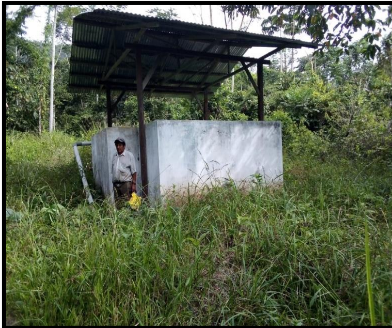
Ilustración 120 : PUNTOS DE CAPTACION DEL AGUA PARA LA DISTRIBUCION
