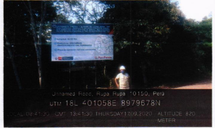
FOTO N°46. Cartel de obra ubicada en el sub tramo II: Porvenir de Marona - Alto Marona en la Progresiva 0+000 Km.
