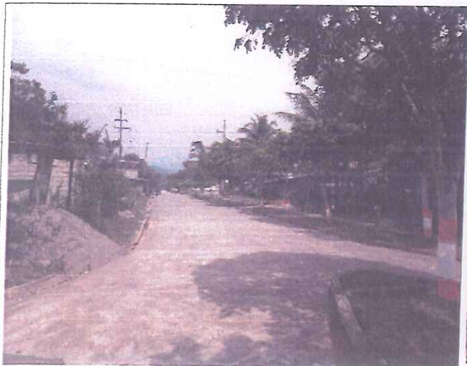
FOTO N° 01: En esta toma se muestra el Ingreso al tramo (PUMAHUASI) – HUAMANCOTO sin señales Informativas.
