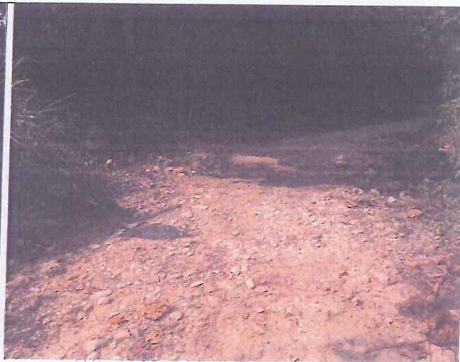
FOTO N° 02: En esta toma se Observa que no hay ningun tipo de señal para poder prevenir una curva cerrara.
