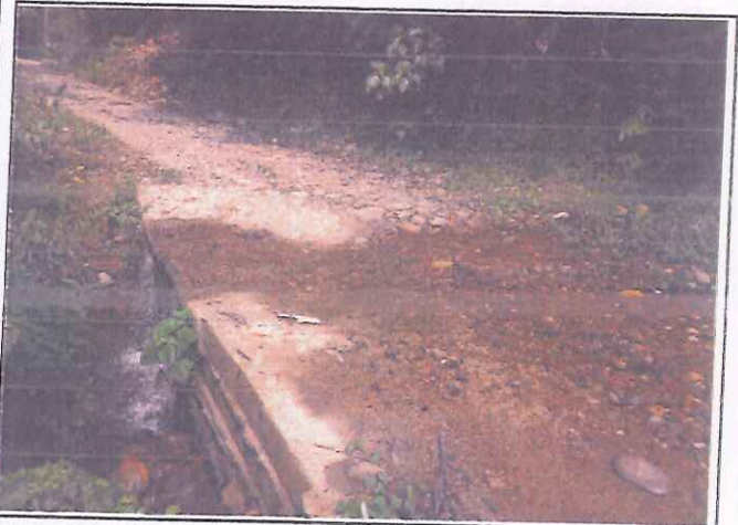
Foto 28. En esta toma se Observa un Baden concreto Parcialmente Obstruido. En la Prog. 1+804.00
