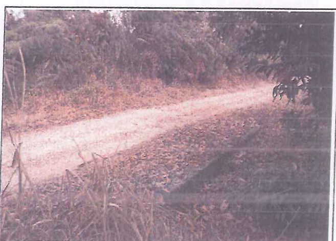
Foto 22. En esta toma se Observa un Baden concreto Parcialmente Obstruido. En la Prog. 2+918.00
