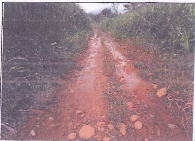
Foto 32. Tramo 02+000 al 03+010, presenta Erosion y Baches de Nivel de gravedad 2 con Profundidad promedio a 10 cm en la Plataforma.
