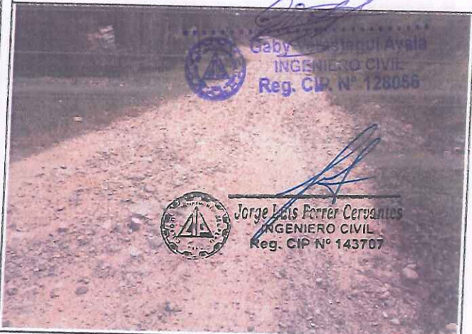
Foto 04. Tramo 00+228 al 01+000, presenta erosión de Nivel de gravedad 2 en la Plataforma.
