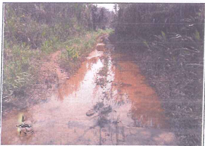
Foto 33. En esta toma se Observa un Baden concreto Totalmente Obstruido. En la Prog. 2+946.00
