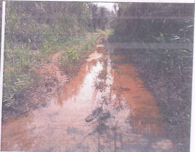
FOTO N° 04: En esta toma se Observa un Baden concreto Totalmente Obstruido. En la Prog. 2+946.00.
