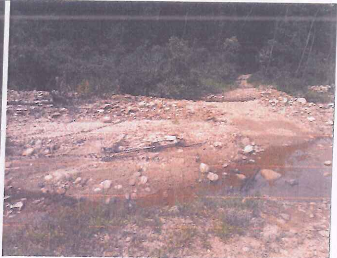
FOTO N° 02: En esta toma se puede apreciar un pase de agua que afecta la plataforma.
