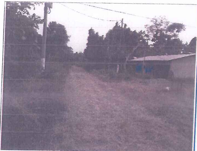
Foto 08. Tramo 04+000 al 04+326, presenta Topografía Ondulado, con un ancho de superficie promedio de 3.00 m.
