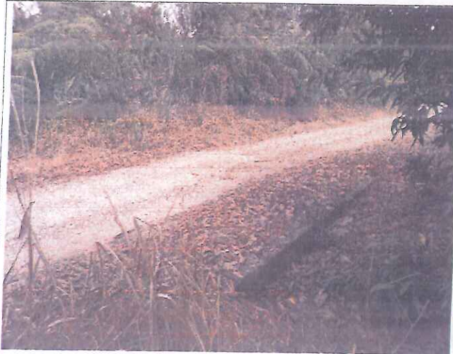
FOTO N° 03: En esta toma se Observa un Baden concreto Parcialmente Obstruido. En la Prog. 2+918.00.
