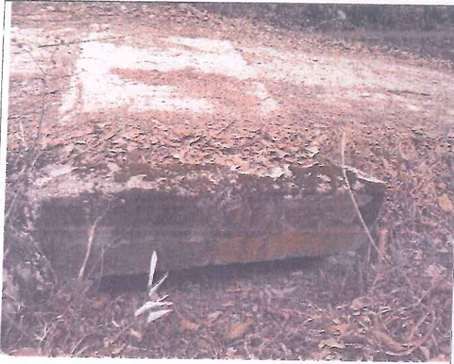
FOTO N° 01: En esta toma se puede apreciar el Ponton de L= 2.50 en la Prog. 1+200.00 totalmente Obstruido.
