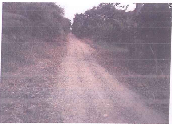
Foto 21. Tramo 02+000 al 03+000, presenta erosión de Nivel de gravedad 2 en la Plataforma.
