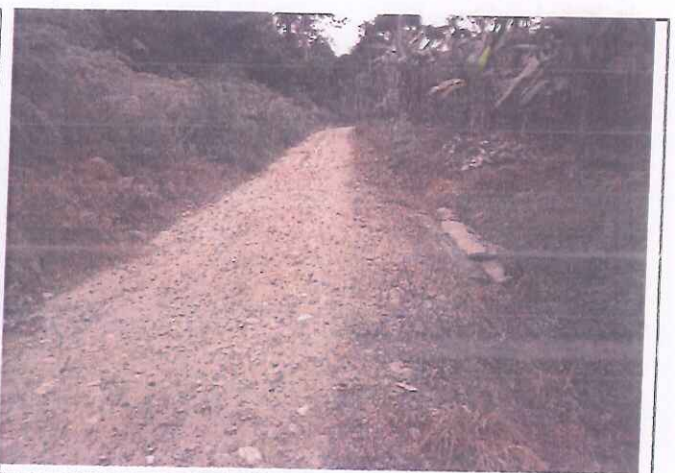
Foto 16. Tramo 00+000 al 01+000, presenta erosion de Nivel de gravedad 2 en la Plataforma.
