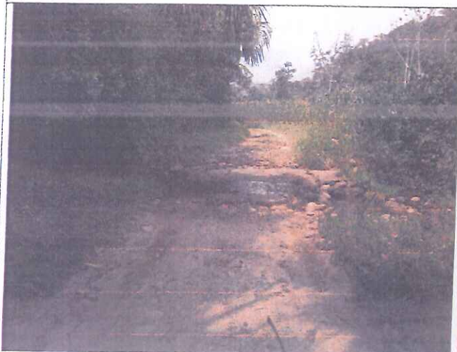
FOTO N° 03: En esta toma se Observa un Baden concreto Parcialmente Obstruido en malas condiciones. En la Prog. 2+440.00.
