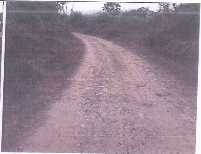
FOTO N° 02: En esta toma se Observa las curvas cerradas y ninguna señalización.
