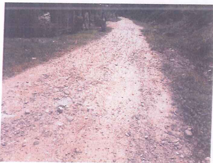
FOTO N°01. Se puede apreciar el estado de la superficie de rodadura entre el km 00+000 – km 03+000 del Sub Tramo I
