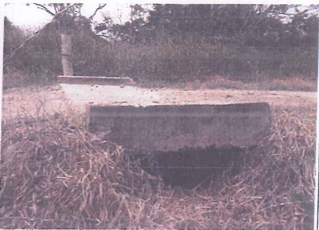
Foto 20. En esta toma se puede apreciar el Ponton de L= 2.50 en la Prog. 2+384.00 Parcialmente Obstruido.
