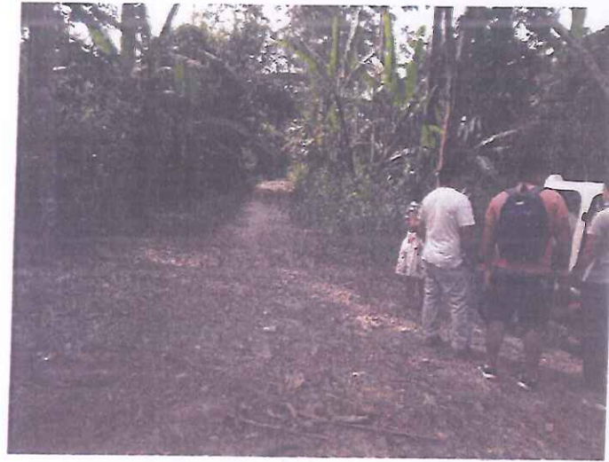
FOTO N°03. Se puede apreciar el estado de la superficie de rodadura entre el km 04+000 – km 04+858 del Sub Tramo I
