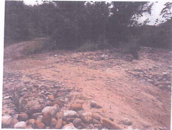
FOTO N°07. Se puede apreciar el estado de la superficie de rodadura entre el km 01+000 – km 03+013 del Sub Tramo III
