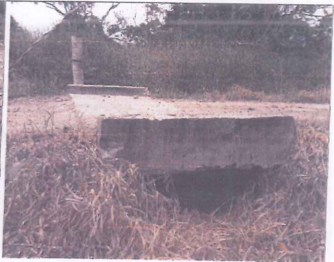
FOTO N° 02: En esta toma se puede apreciar el Ponton de L= 2.50 en la Prog. 2+384.00 Parcialmente Obstruido.
