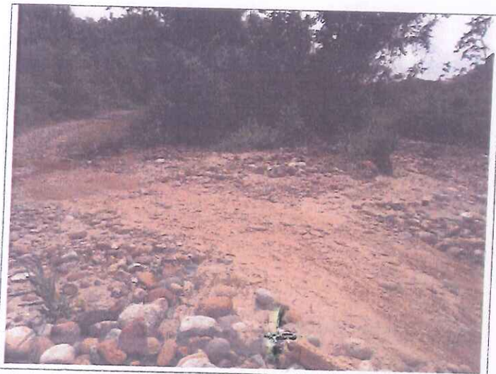
Foto 01. Se evidencia deslizamiento de la superficie de rodadura ocasionado por un Rio que contiene materiales gruesos en sus cauce y que atravieza la via. Prog 2+034
