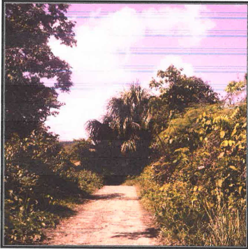
VISTA FOTOGRÁFICA DE LA CALICATA 11, PROGRESIVA 02+500, donde se aprecia la medición del afirmado registrado en campo E= 5.00 cm, además se puede apreciar la invasión de las plantas silvestres en toda la plataforma, las cunetas que se encuentran cubiertas por material deslizados del talud y plantas silvestres.
