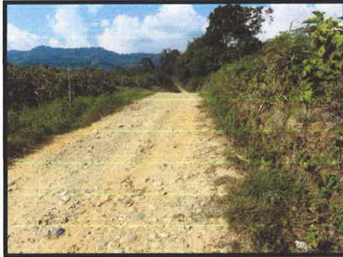
Se puede apreciar que las cunetas se encuentran con maleza y obstruidas.
