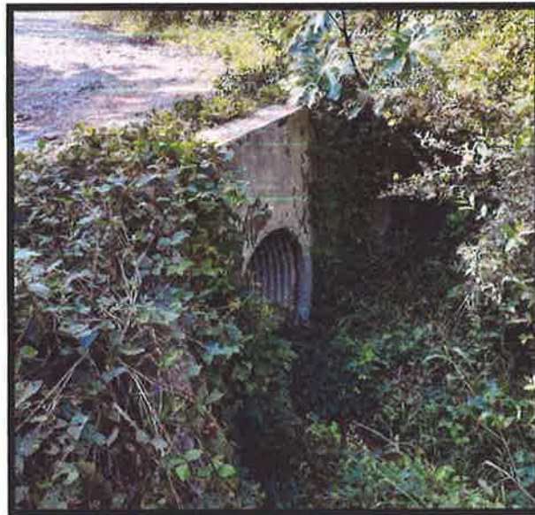
Se puede apreciar que las alcantarillas se encuentran obstruidas con sedimentos obstruyendo el curso del agua.
