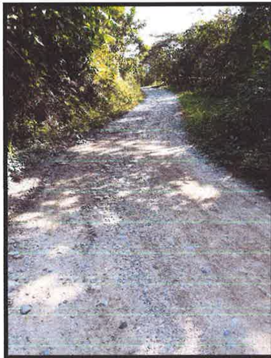
Se puede apreciar que las cunetas se encuentran con maleza y obstruidas.
