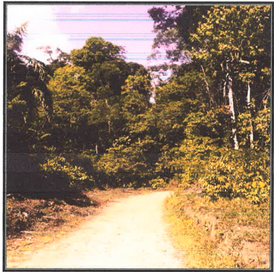
VISTA FOTOGRÁFICA DE LA CALICATA 10, PROGRESIVA 02+250, donde se aprecia la medición del afirmado registrado en campo E= 5.00 cm, además se puede apreciar la invasión de las plantas silvestres en toda la plataforma, las cunetas que se encuentran cubiertas por material deslizados del talud y plantas silvestres.
