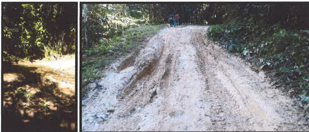
En la imagen se puede apreciar el estado actual del camino vecinal – del tramo 1: Pacae – Alto Pacae.
