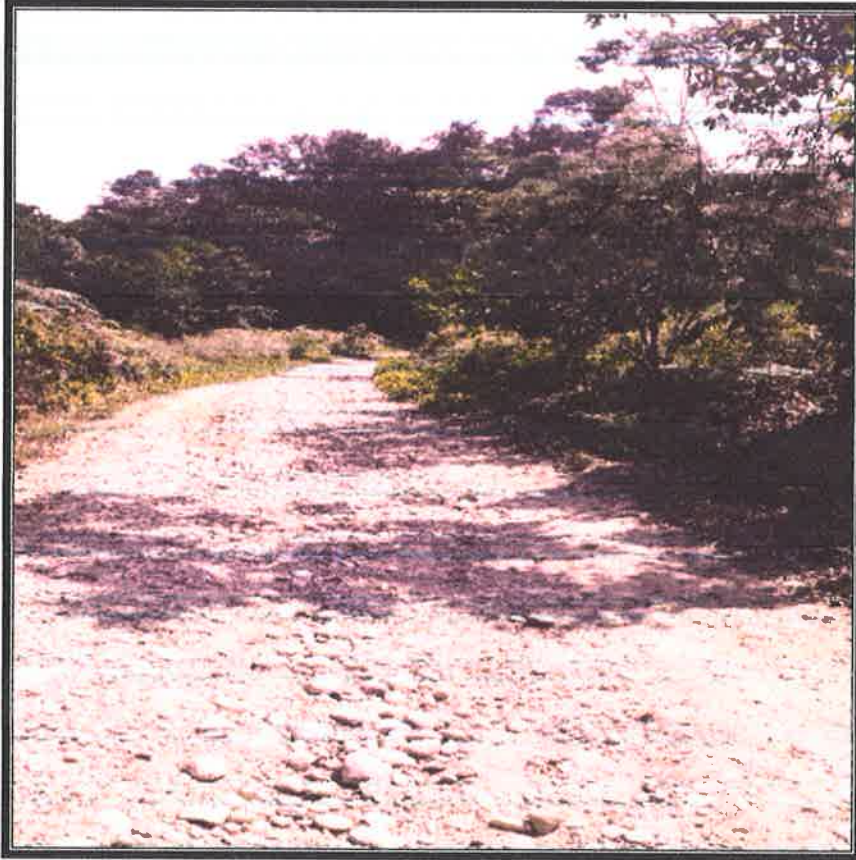
VISTA FOTOGRÁFICA DE LA CALICATA 08, PROGRESIVA 01+750, donde se aprecia la medición del afirmado registrado en campo E= 0.00 cm , además se puede apreciar la invasión de las plantas silvestres en toda la plataforma, las cunetas que se encuentran cubiertas por material deslizados del talud y plantas silvestres.
