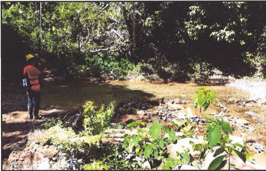
FOTO N° 08 se puede apreciar el estado de la superficie de rodadura entre el km 00+000 – km 03+920
