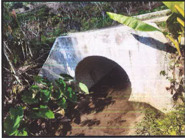
Se puede apreciar que las alcantarillas se encuentran obstruidas con sedimentos obstruyendo el curso del agua.
