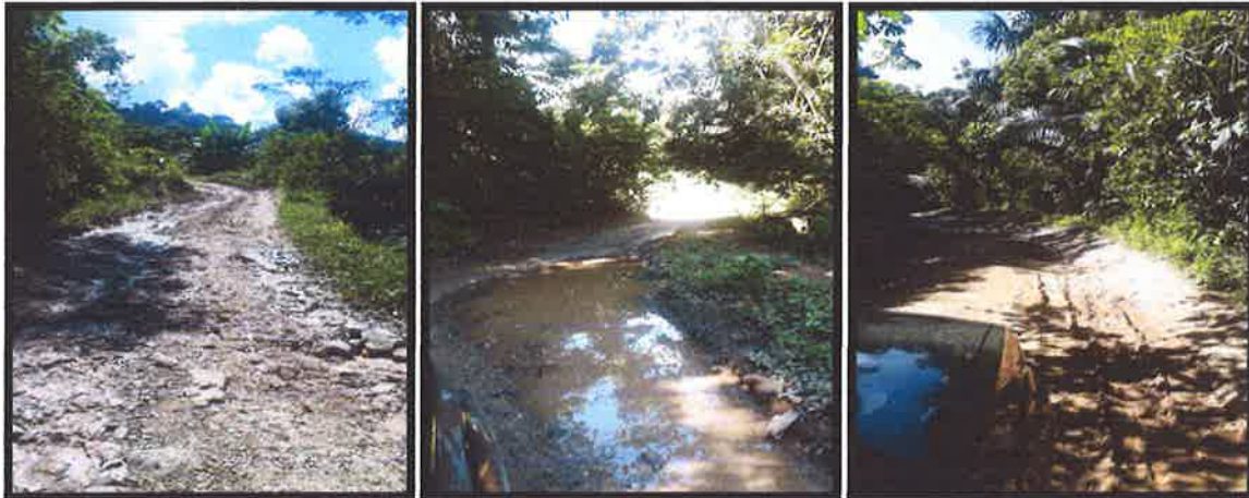
En la imagen se puede apreciar el estado actual del camino vecinal – del tramo 1: Pacae – Alto Pacae.
