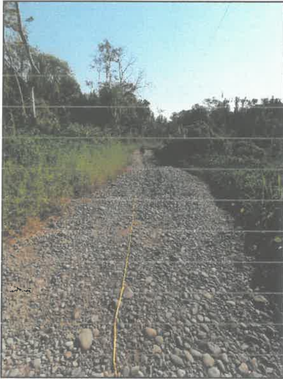
FOTOGRAFÍA N° 21: CODIGO SSR05: Se observa el tramo N° 02 Shiringal – CPT, entre las progresivas 0+740.00 - 0+760.00, que se presentan daños en la superficie de rodadura de tipología Baches.
