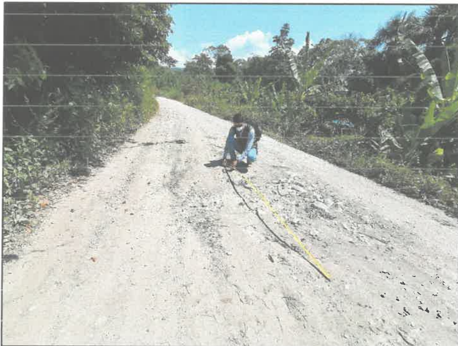
FOTOGRAFÍA N° 06: CODIGO VSR06: Se observa el tramo N° 01 Venenillo – Corvina, entre las progresivas 1+740.00 - 1+760.00, que se presentan daños en la superficie de rodadura de tipología Baches.
