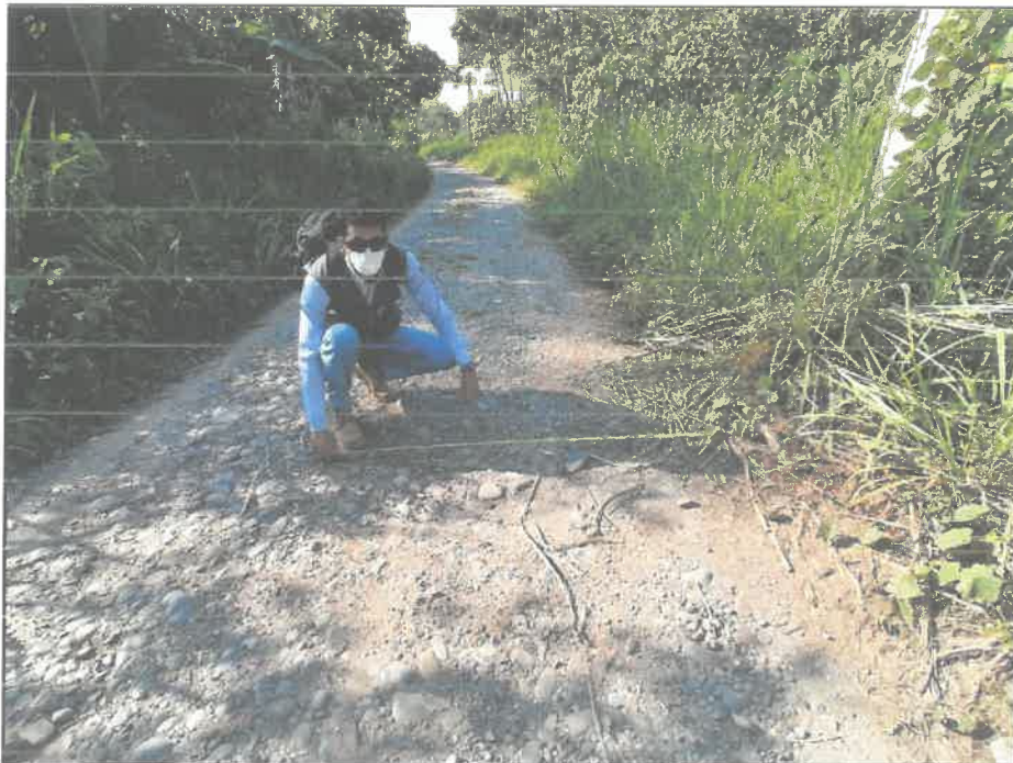
FOTOGRAFÍA N° 22: CODIGO SSR06: Se observa el tramo N° 02 Shiringal – CPT, entre las progresivas 1+510.00 - 1+530.00, que se presentan daños en la superficie de rodadura de tipología Baches.
