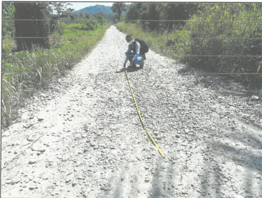
FOTOGRAFÍA N° 10: CODIGO VSR10: Se observa el tramo N° 01 Venenillo-Corvina, entre las progresivas 4+430.00 - 4+450.00, que se presentan daños en la superficie de rodadura de tipología Baches.
